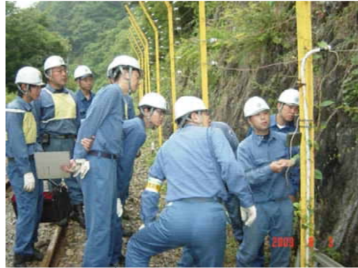
[施設グループ]落石警報装置作動時の処置
